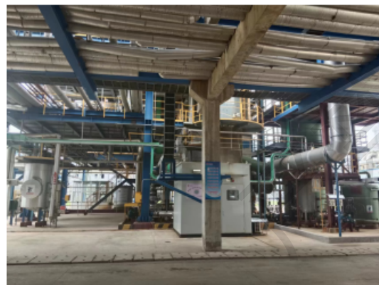
南侧硫回收装置
