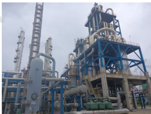
西侧甲醇合成装置
